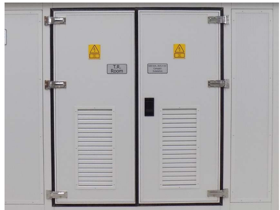
Kompakt Trafo Merkezi Kapısı
